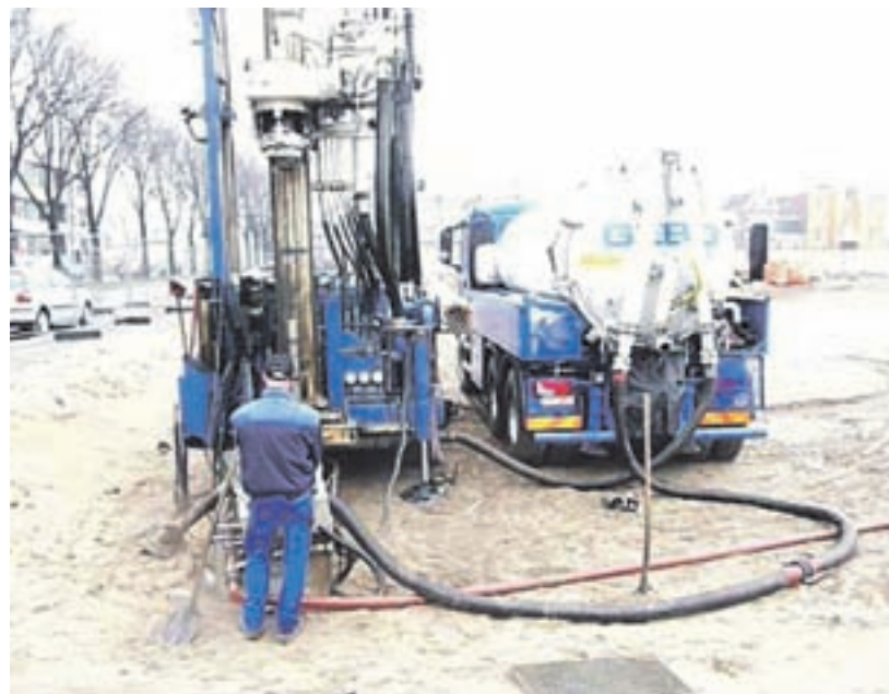
De pijpen voor de warmtekoude opslag
