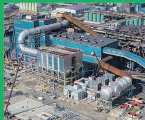
De ontstoffingsinstallatie bij de Pelletfabriek
