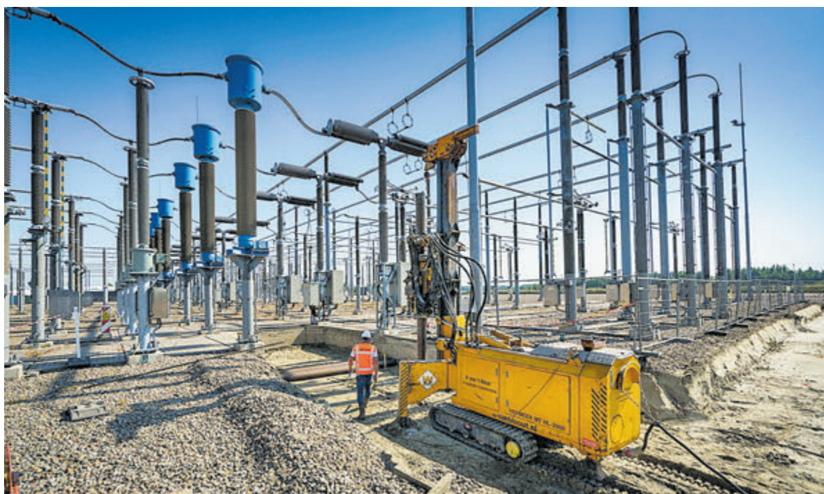
De provincie heeft een handreiking voor netbeheerders en gemeenten ontwikkeld voor de aanleg van elektriciteitsstations in ons landschap. Foto: TenneT
