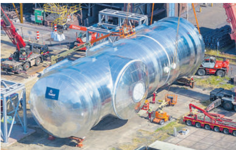
Het is de bedoeling om de nieuwe milieu-installatie nog voor het eind van dit jaar in gebruik te nemen. Foto: aangeleverd
