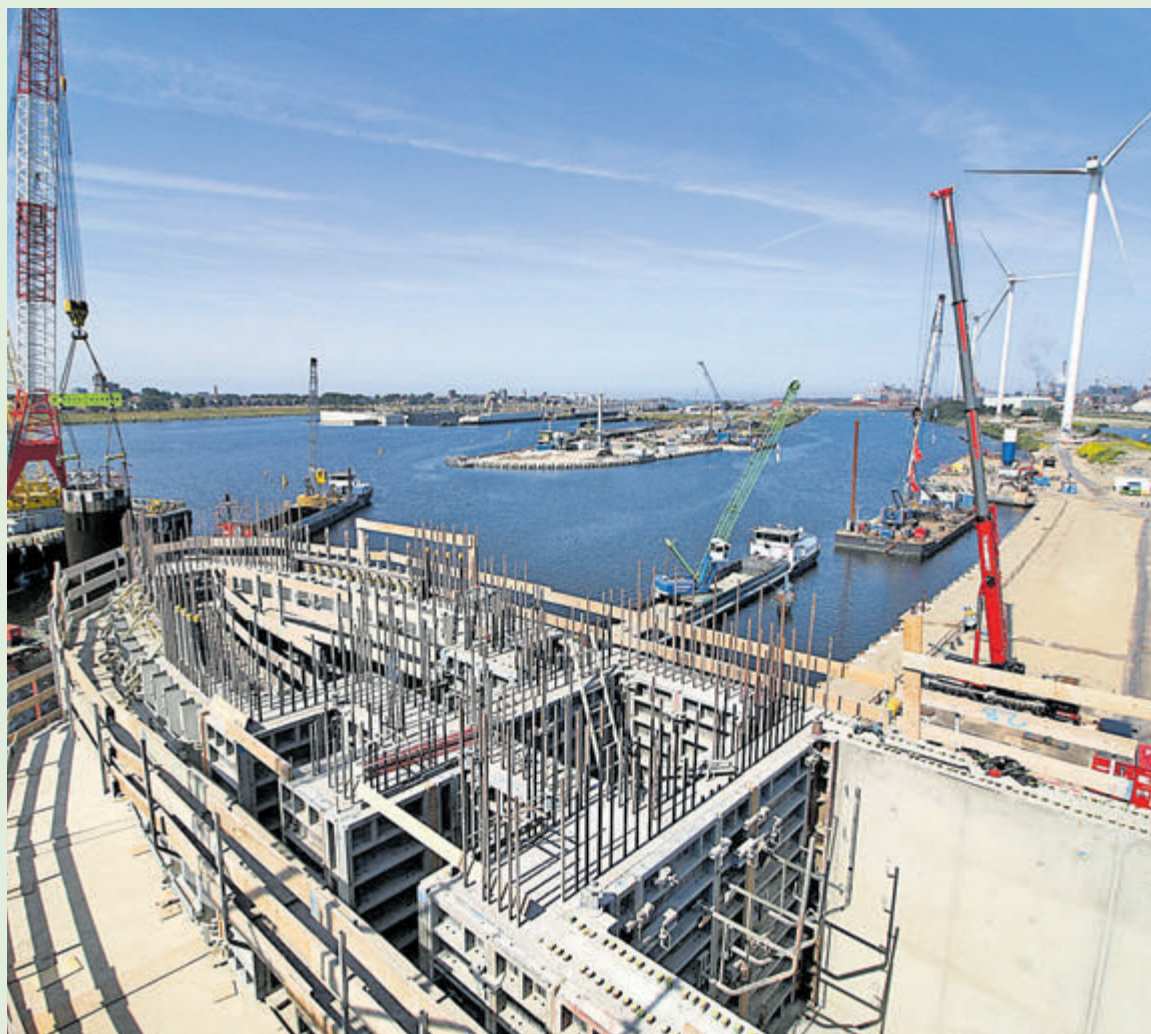
Blik vanaf bovenop de bouwsteiger tussen de pijlers, met links het afhijsen van een meerstoel, een van de pijlers in aanbouw in het midden en rechts een stukje bouwplaats. Op de achtergrond zien we IJmuiden, de Zeesluis IJmuiden en de Noordersluis in het midden, het Binnenspuikanaal en rechts de hoogovens. Foto: Erik Baalbergen
