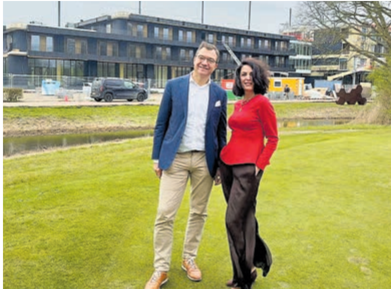
Algemeen manager Bernard Lensink en HR-projectmanager Mirjam Swart met op de achtergrond het in aanbouw zijnde hotel. Foto: Spaarnwoude Park Hotel
