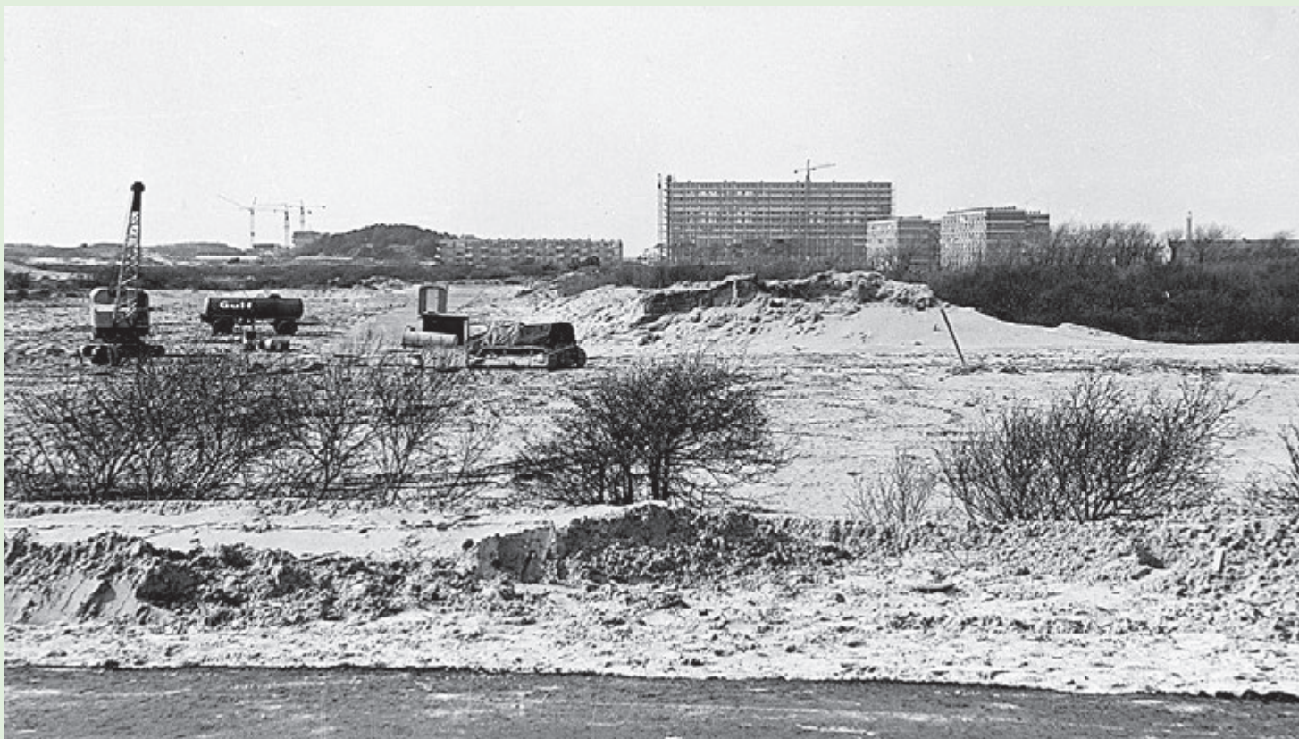
Blik op de bouw van Zeewijk, ca. 1966. We kijken over het latere Georgebos en Vierkante Bos naar het noordwesten. Rechts van het midden zien we de twaalfhoogflat aan de Orionweg in aanbouw. Rechts van deze flat zien we de maisonnetwoningen aan de Bellatrixstraat en links de flats aan het Hazevlak. Verder links de duinop Dennekop en de bouw van de zeshoogflats aan de Dennekoplaan ende twaalfhoogflat aan de Keetberglaan. De weg vanuit het midden naar de voorgrond lijkt de latere Schiplaan. Foto: Frits Houtgraaf
