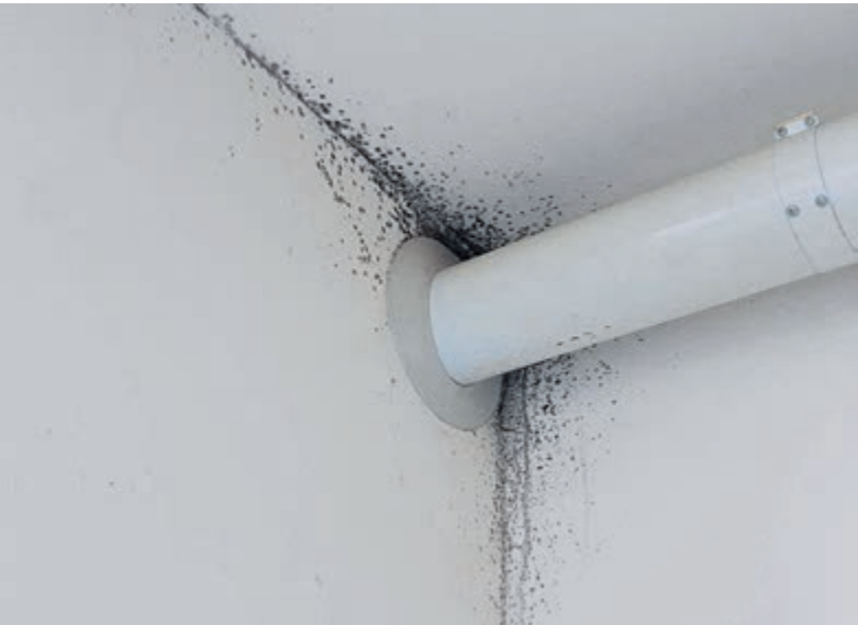
Vochtige muren en schimmelvorming blijkt in veel sociale huurwoningen een probleem te zijn. Foto: aangeleverd
