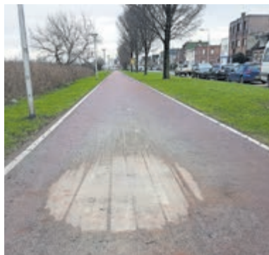
Het fietspad aan de IJmuiderstraatweg is door vuurwerk beschadigd. Foto: Arita Immerzeel
